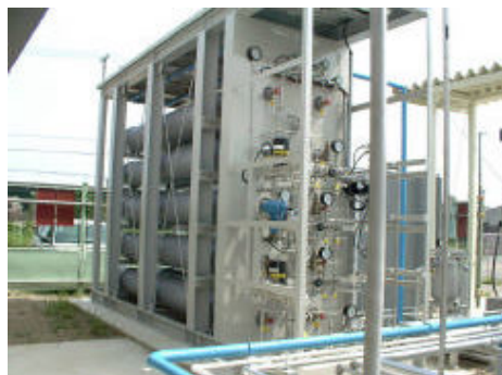
Figura 22. Unidade de armazenamento de GNC
