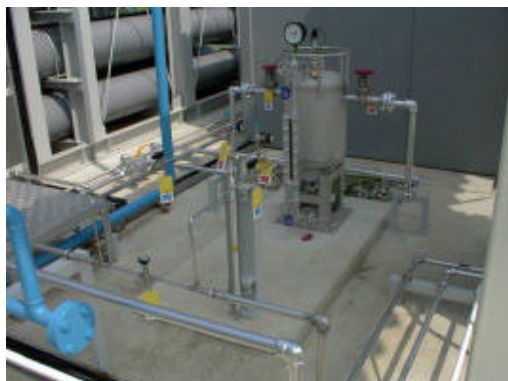
Figura 21. Unidade de odorização do GNC
