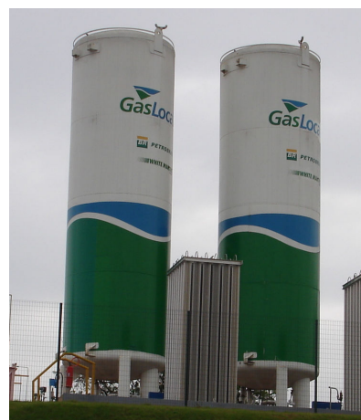
Figura 15. Tanques de armazenamento de GNL.
