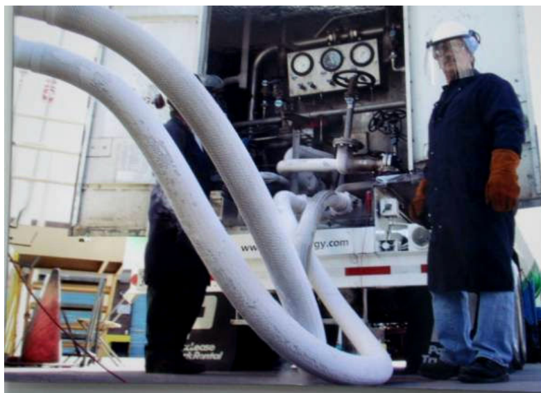
Figura 14. Abastecimento do reservatório de GNL através do caminhão
