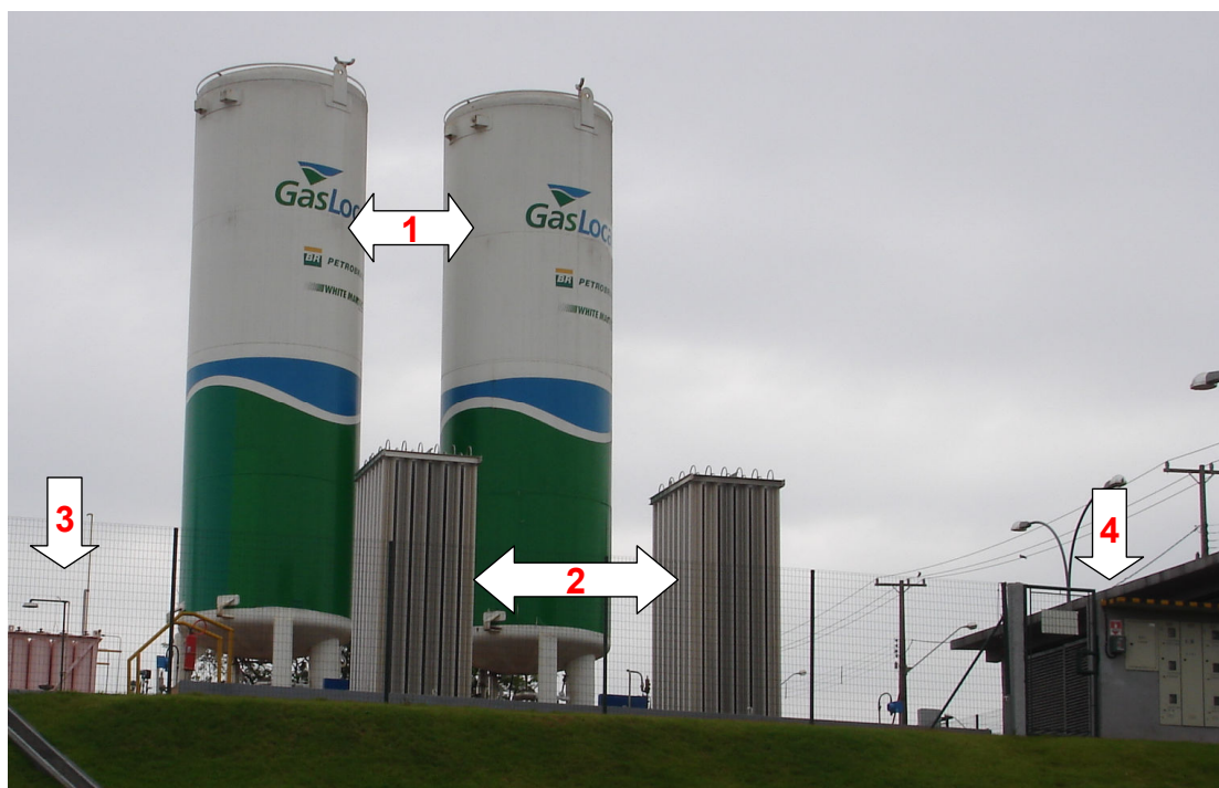
Figura 39. Capacidade de armazenamento de GNL instalada 1 – Tanques de armazenamento de GNL; 2 – TC tipo Vaporizadores; 3 – Tanque de armazenamento de GNC; 4 – Central Eletrônica de Monitoramento da Instalação.
